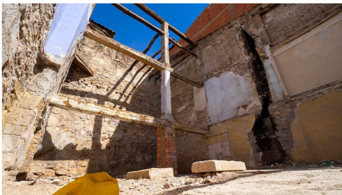
Imatge de l'edifici enderrocat | Cedida
